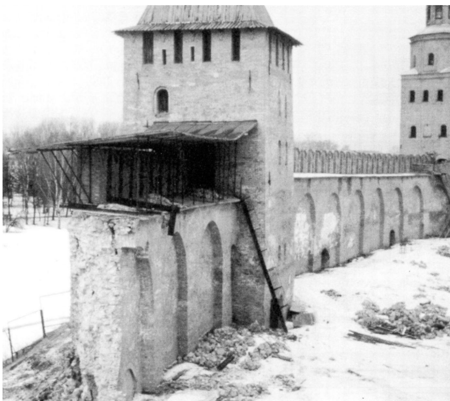
Третья башня новгородского кремля, XV в. Разрушенный фрагмент стены между башнями. Видно, что стена имеет два каменных фаса, между которыми засыпан валун.
