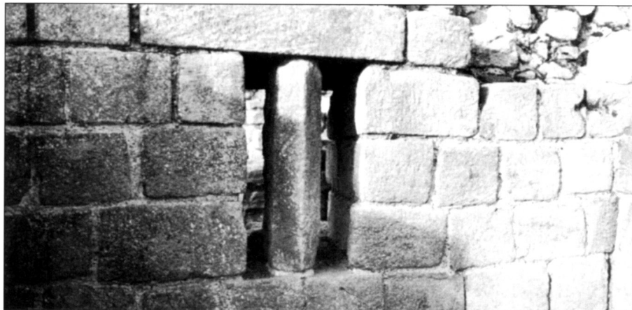
Вентиляционное отверстие подпола западного амбара Корбриджа (Кория). Через это отверстие в подпол проникал сухой воздух, защищавший продукты от сырости и плесени.
