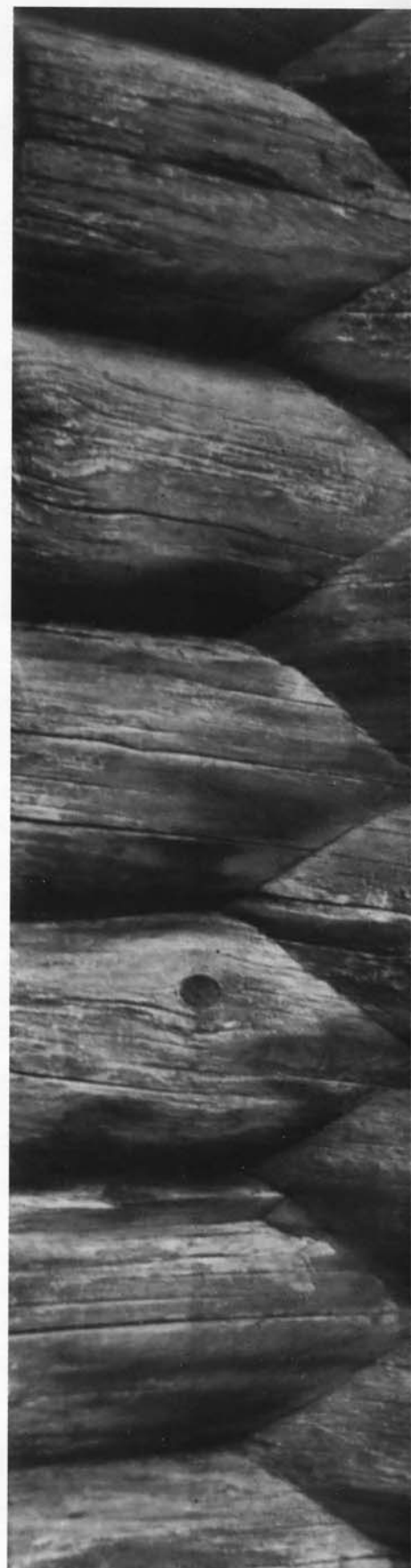
Состояние сруба Никольской церкви (1693 г.) погоста Астафьево
